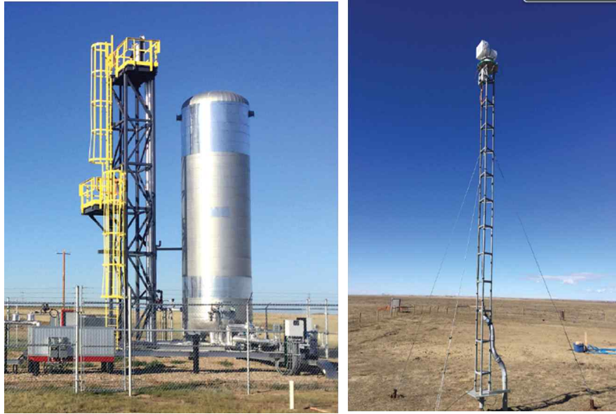
a. 이산화탄소 저장탱크 및 콘덴서 타워 설비 b. 이중 주파수 조합레이저 분광계
