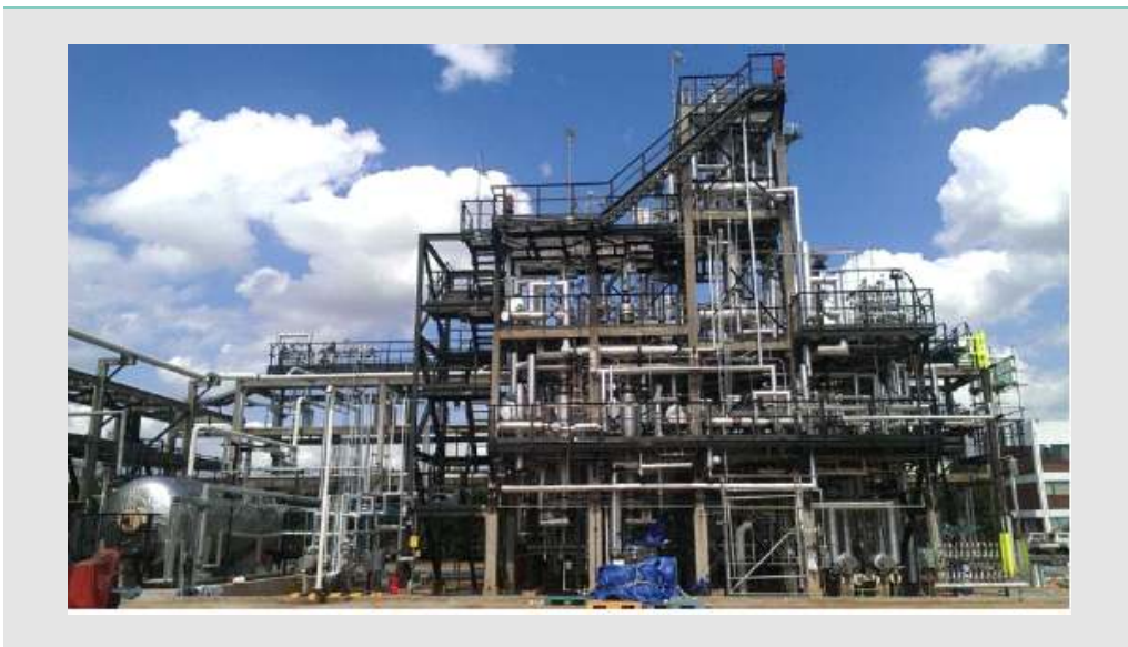
SK에너지 울산공장의 수첨바이오디젤 생산 플랜트 전경
